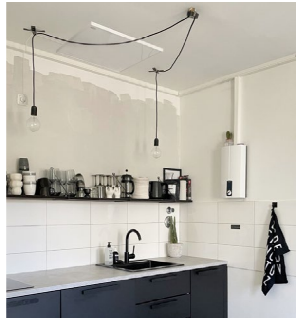
Deckenheizung in der Küche.
