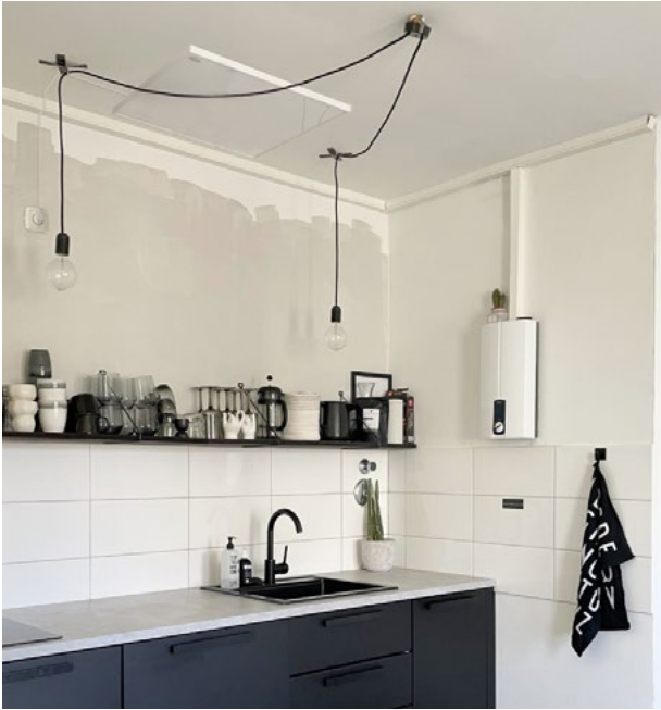
Deckenheizung in der Küche.
